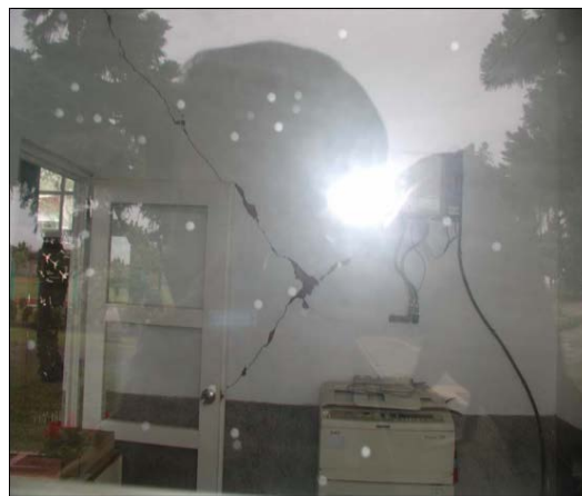
平行走廊內磚牆嚴重龜裂(校長室內之磚牆)。
