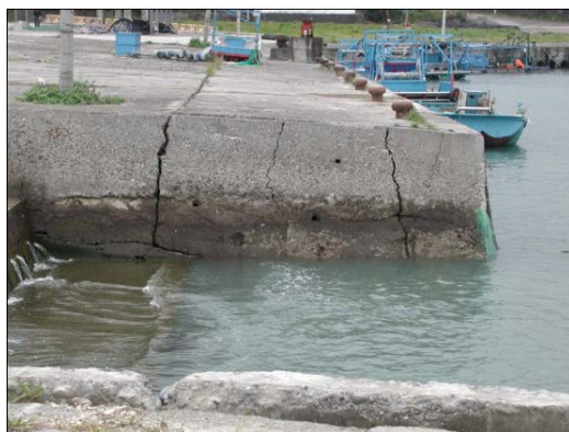
西堤開裂（北端）
