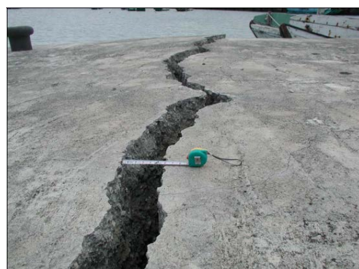
凸堤開裂（近照）
