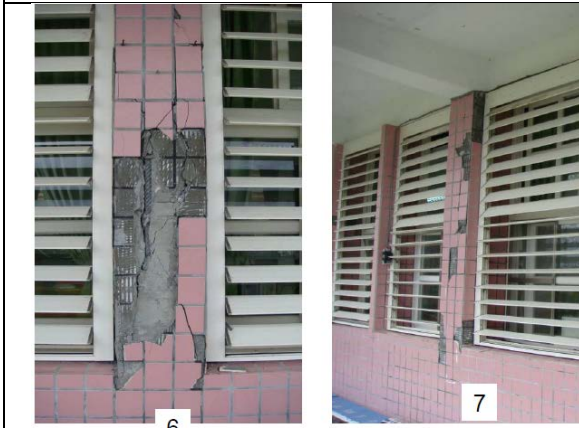
室外實際裂縫開裂
