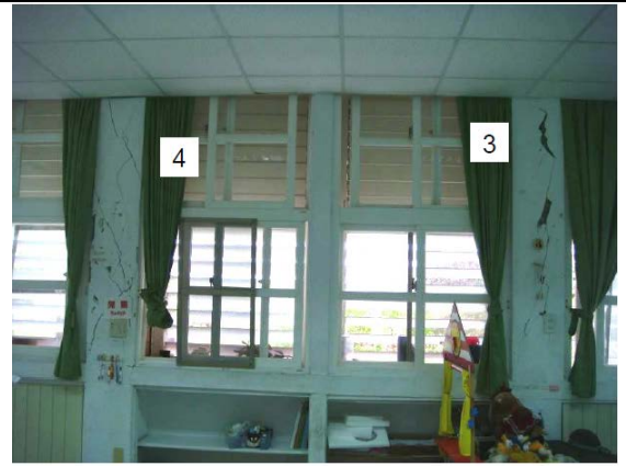
一樓室內實際裂縫開裂
