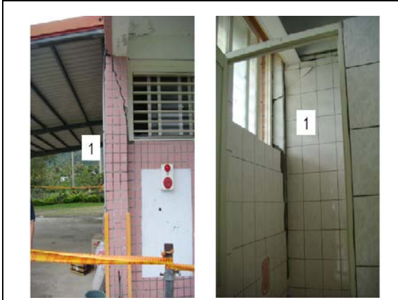
一樓室外、內實際裂縫開裂
