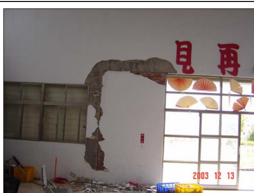
禮堂入口旁之磚牆震裂(與 RC 柱之界面處)
