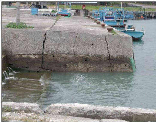
西堤開裂(北端)
