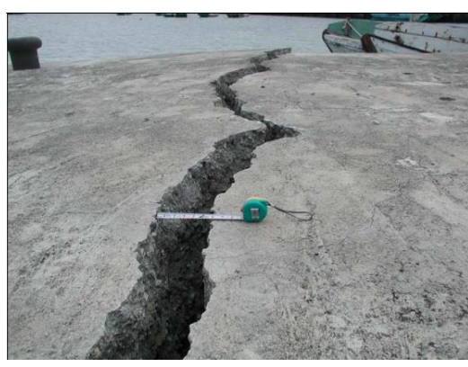
凸堤開裂(近照)
