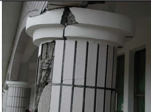
走廊圓柱發生剪力破壞(洗手台造成該柱較短，約一百公尺長之走廊僅此柱破壞。
