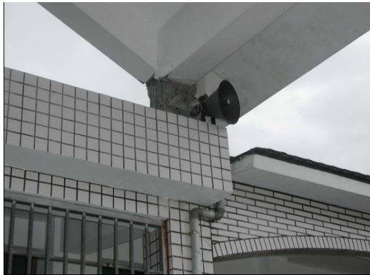
信義國小樓梯雨遮支柱頂部分損壞(右柱)，短柱效應造成力量集中於短柱。
