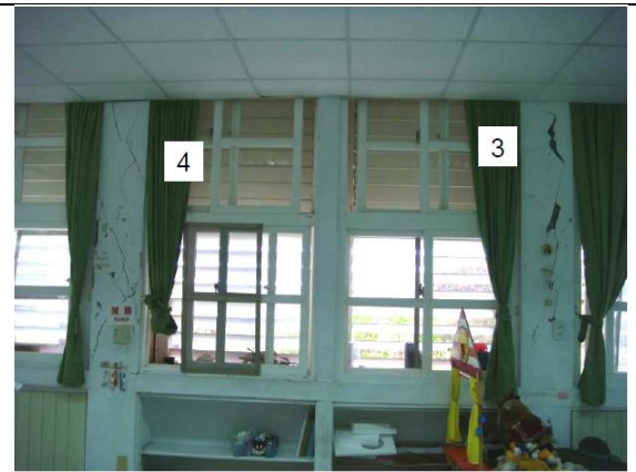
一樓室內實際裂縫開裂
