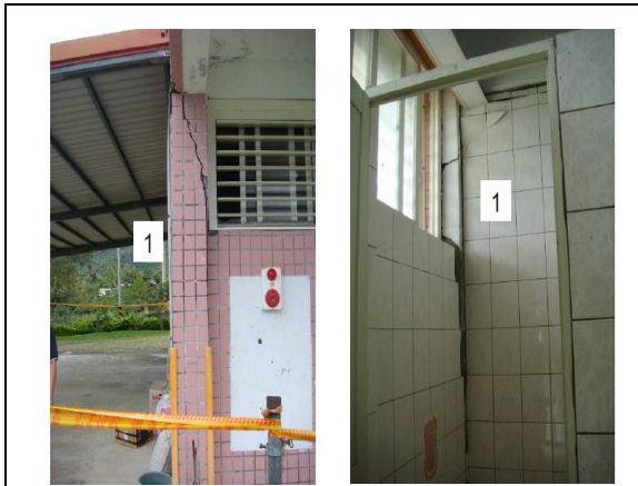
一樓室外、內實際裂縫開裂
