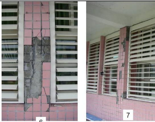
室外實際裂縫開裂
